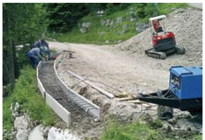
Guardrail tornanti Ra Stua
