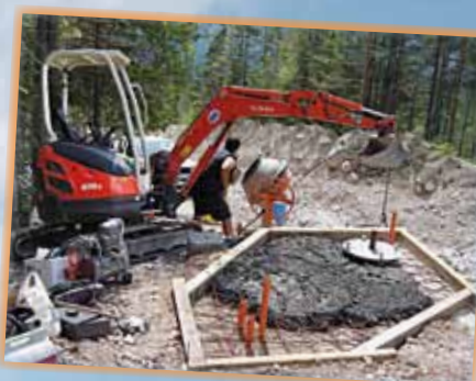
Stazione monitoraggio frana Acquabona
